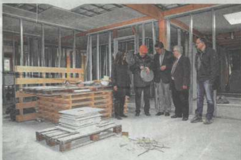
Generalplaner Rolf Winter (2.v.l.) erläutert während des Rundgangs durch die neue Etage den Einsatz von Moosgummibändern zur Schallentkopplung. Angelika Görlich, Heiner Mausehund, Bezirksbürgermeister Gerhard Barnscheidt und Ulrich Meisenheimer (v.l.) hören zu. Foto: MG
